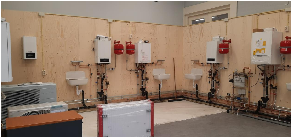
De warmtepomp ruimte
