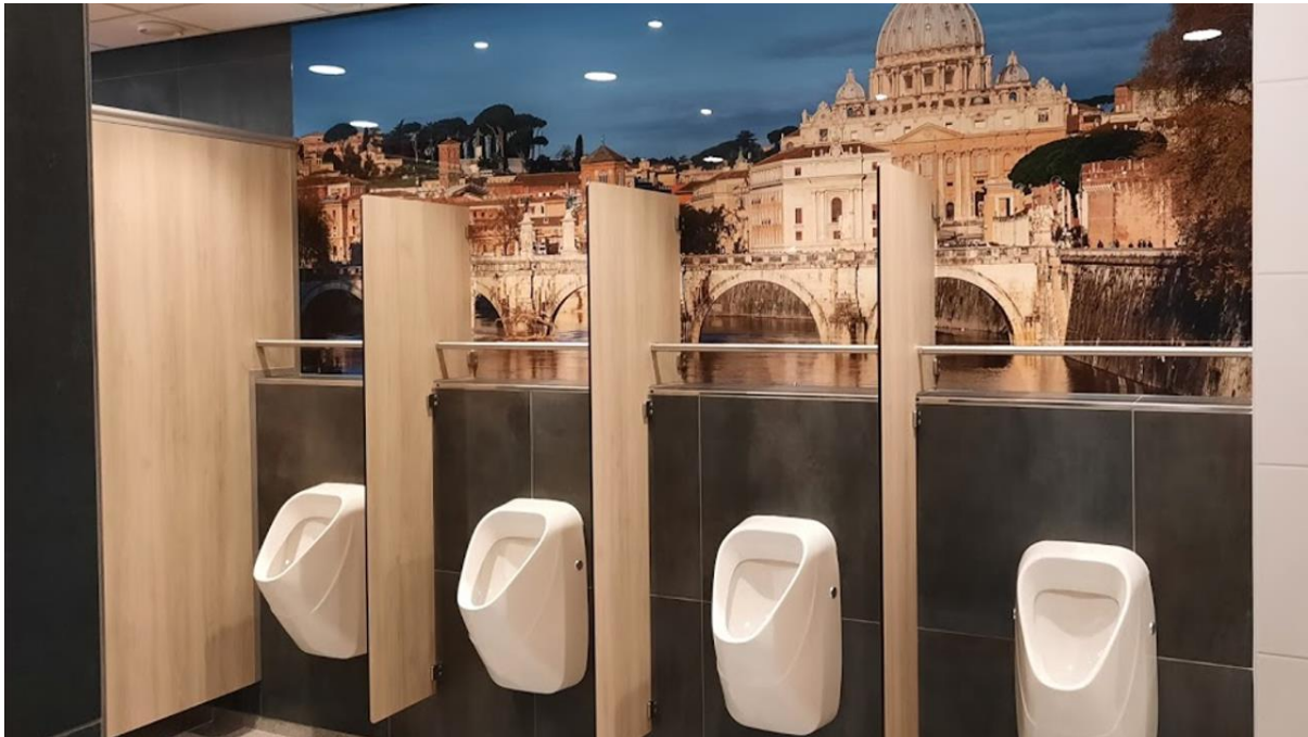
Duurzame waterbesparende toiletten met sensoren.
